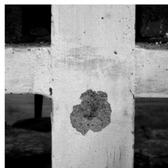
图 7 节点下方混凝土圆形脱落 Fig 7 Concrete circle spall under joints
