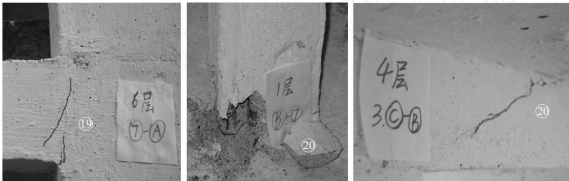
(d) 梁、剪力墙相交处的竖向裂缝
